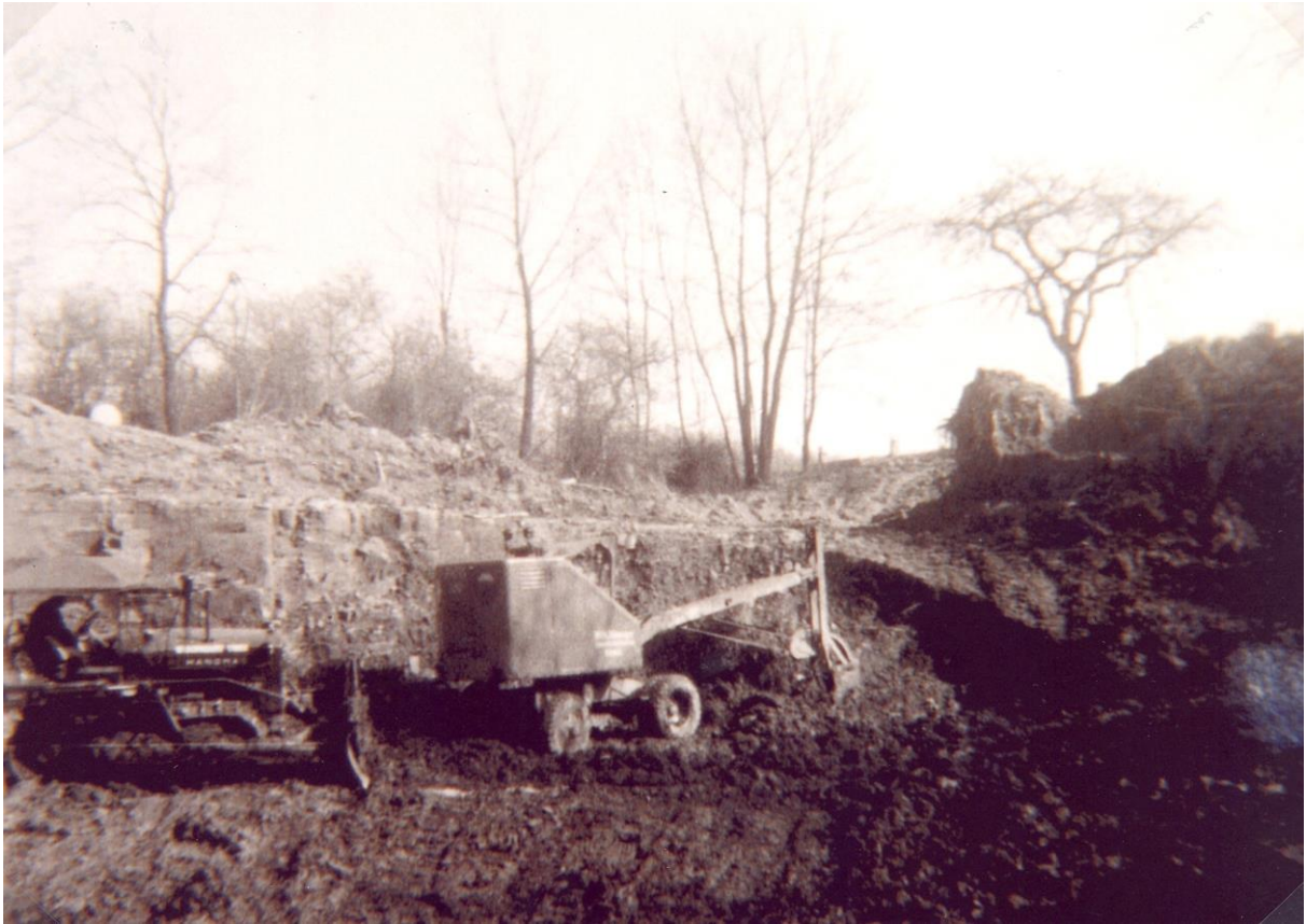
Abb. F18.3: Der Linhoff'sche Steinbruch nach dem 2. Weltkrieg: Freilegungsarbeiten mit Bagger und Raupe; Repro: Verf.
